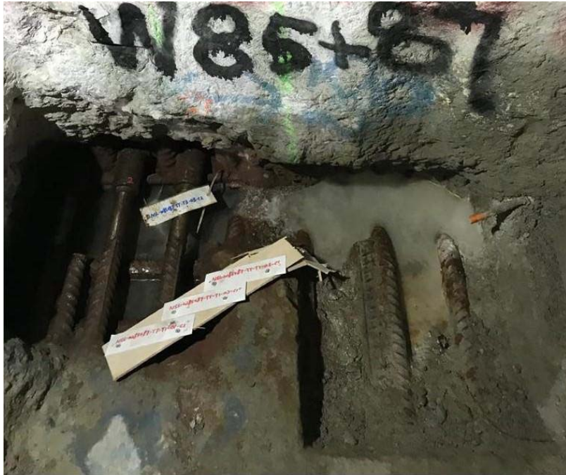
圖 3-7 南北走廊月台已開鑿位置的積水
