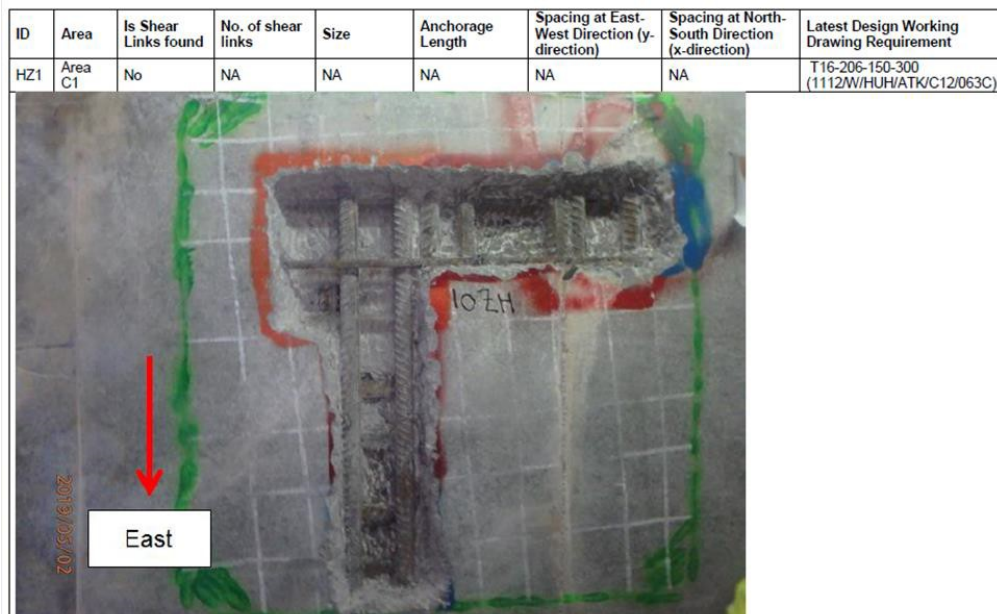
圖 3-5 顯示未有安裝抗剪箍筋的照片
