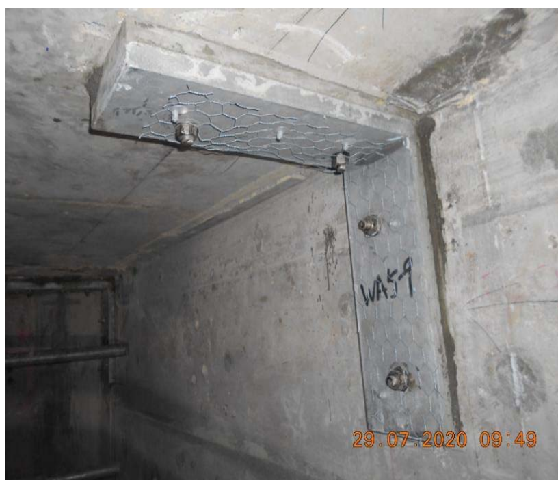
圖 3-11 安裝於軌道上方排氣層板管道內的角鋼托架
