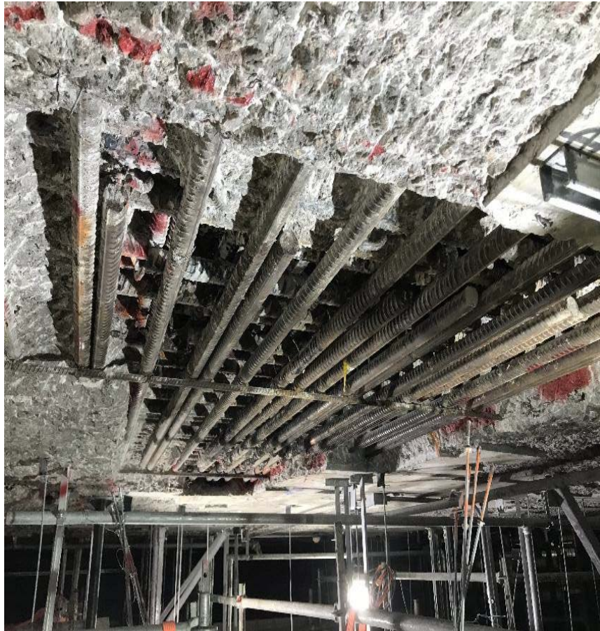
圖 3-4 在東西走廊層板底部移除出現蜂窩現象的混凝土後出現較深層蜂窩現象的位置之一
